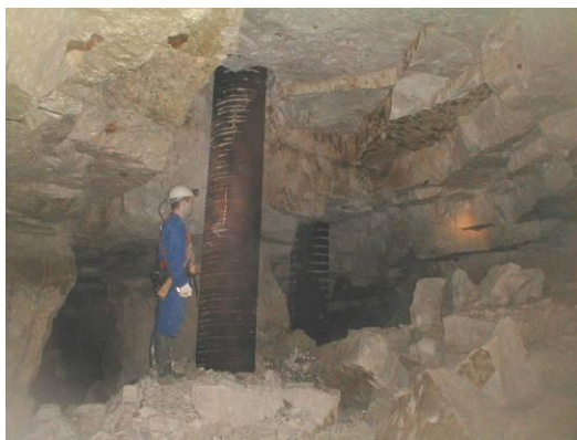
Pieu traversant une cavité
