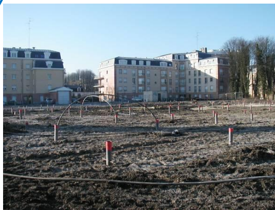
Forages réalisés suivant une maille au niveau d'une zone sous-cavée
