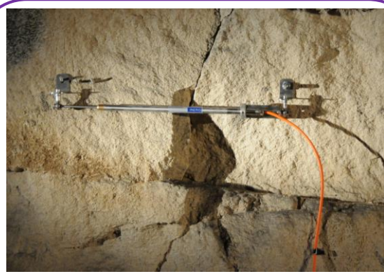
Surveillance par fissuromètre
