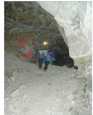
Quantité importante de remblais de pied
